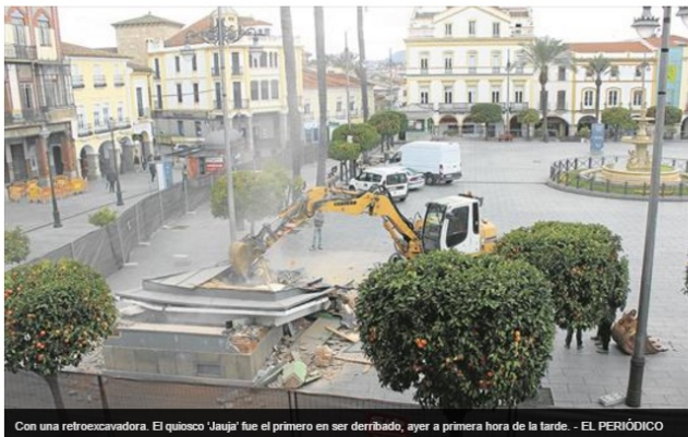
Con una retroexcavadora. El quiosco 'Jauja' fue el primero en ser derribado, ayer a primera hora de la tarde. - EL PERIÓDICO
